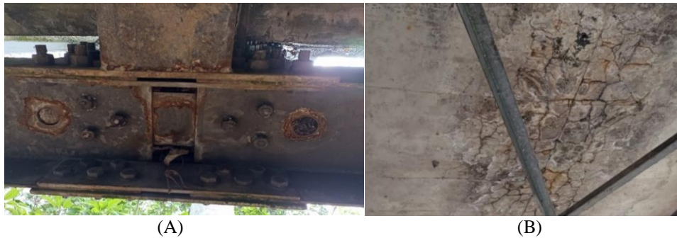
Gambar 3.1 (A) karat pada sambungan baut, (B) spalling pada lantai jembatan.
